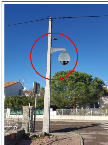
Fixation sur poteau ERDF
